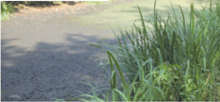
An anderen Stellen ist nur noch eine schlammige Masse vorhanden.
