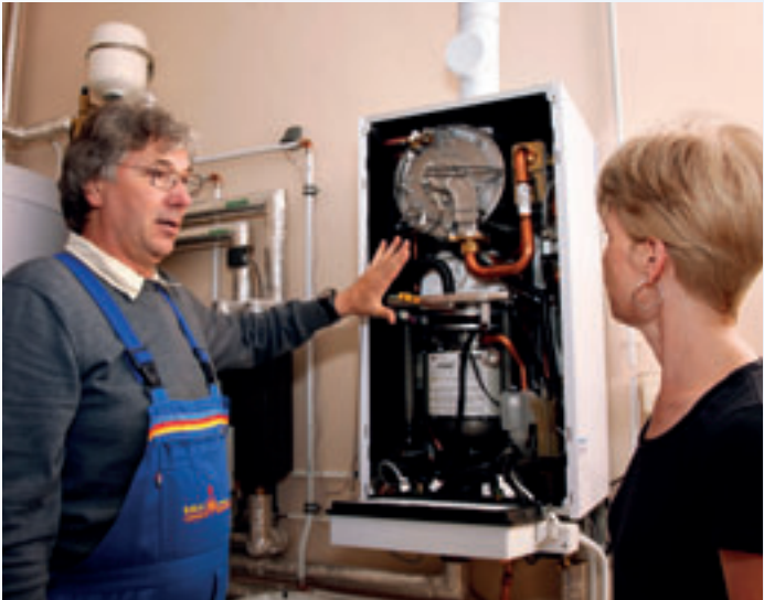
Mit effizienter Gas- und Ölbrennwerttechnik, Wärmepumpen, KWK-Systemen, aber auch Holz- und Pellet-Systemen kann man gegenüber früher genutzten Heizungsanlagen heute bis zu 30 Prozent Energie einsparen. Foto: Allianz Freie Wärme/BDH/TRD Energie und Umwelt/akz-o
