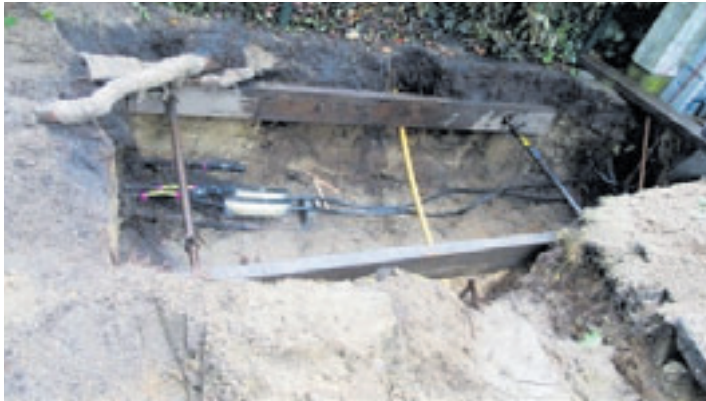
In dieser Baugrube brannte eine rund zwei Meter hohe Gasflamme Fotos: W. Marsand
