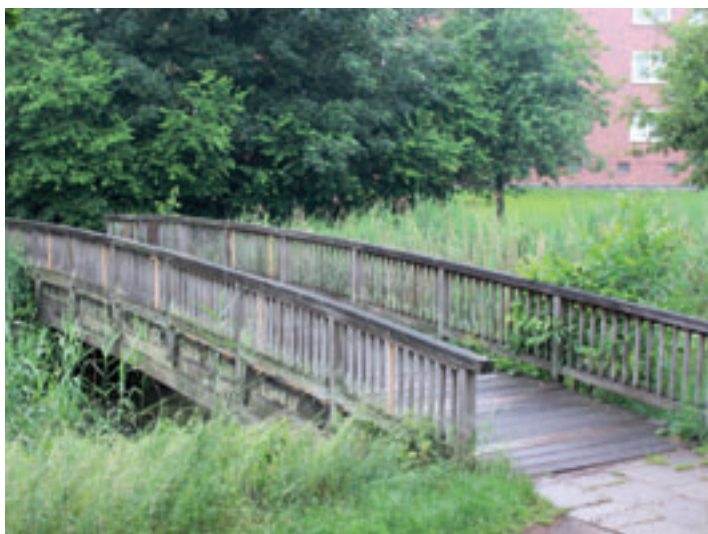
Ist in die Jahre gekommen: Die Brücke über das Fleet
