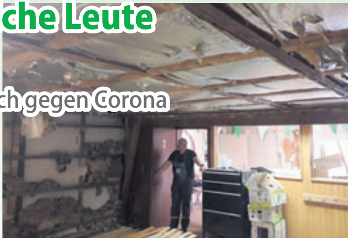
Zurzeit ruht der Schießbetrieb bei den Moorburger Schützen, auch wegen der Sanierung des Schießstandes Foto: SV Moorburg
