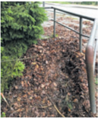
Alles verstopft: Hier kann kein Regenwasser ablaufen Foto: mk
