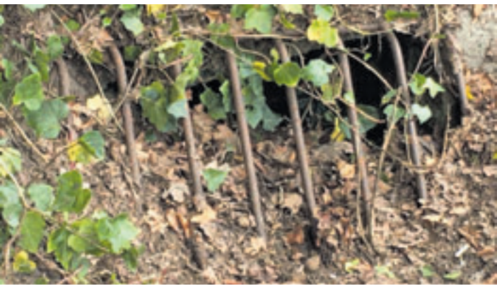
Mit der oberflächlichen Entfernung des Laubes sind die Probleme nicht behoben Foto: mk
