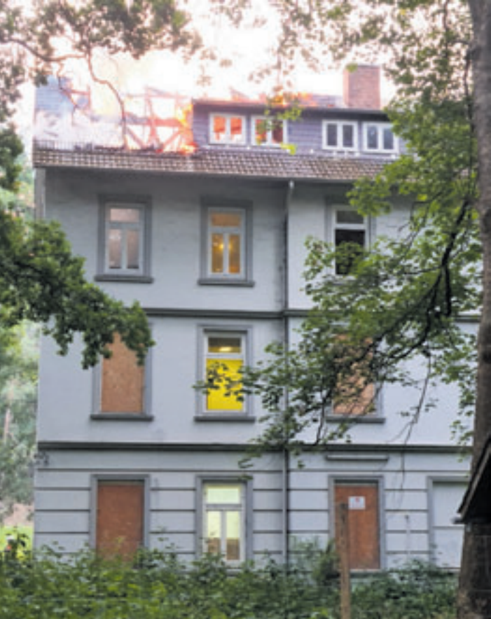
Flammen schlugen durch den völlig zerstörten Dachstuhl.
