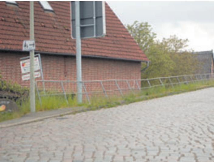
Das Fußgängerschutzgitter am Neuenfelder Fährdeich soll instandgesetzt werden. Zwei Schlaglöcher in der Fahrbahn sollen ebenfalls behoben werden. Foto: mk
