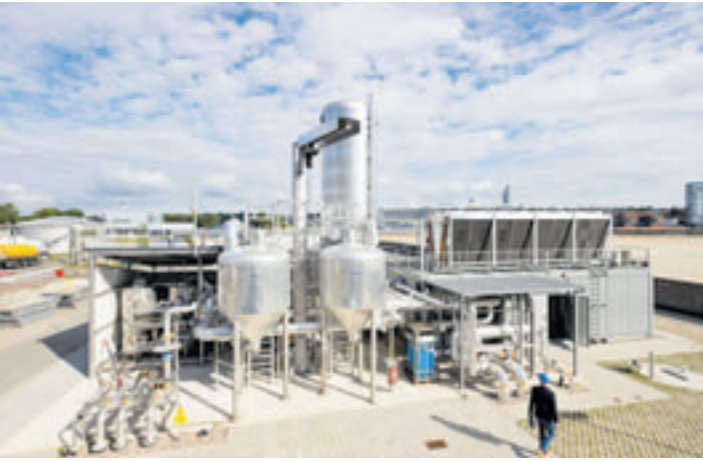
Die GALA2 sorgt für mehr Biogas im Netz Foto: Hamburg Wasser
