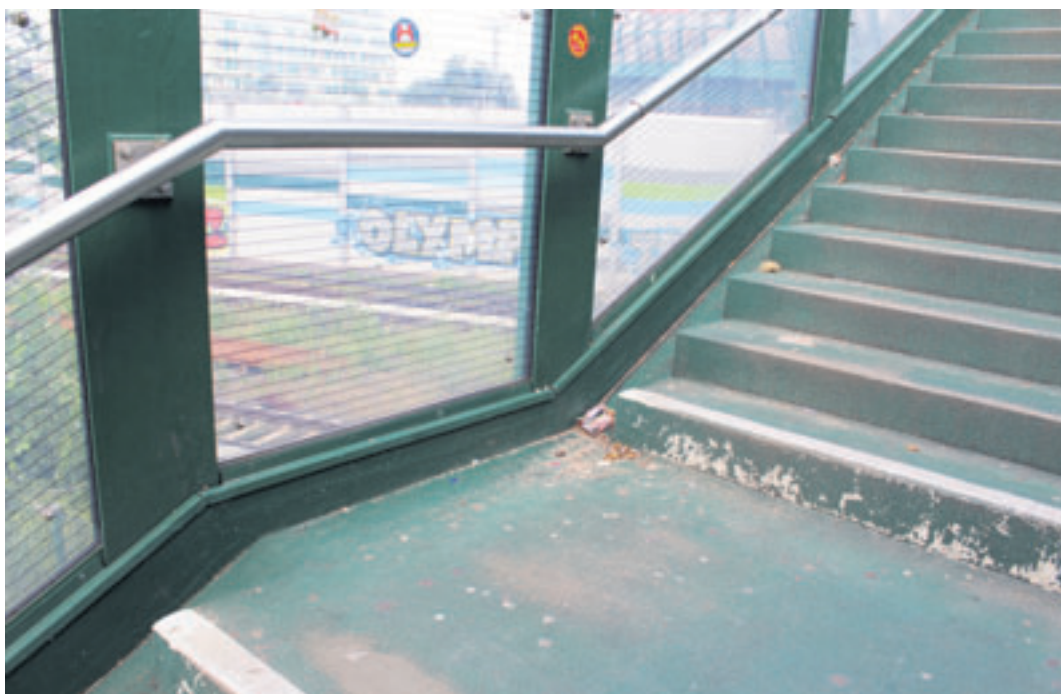
Abgenutzte Treppenstufen, Dreck, Kaugummis: Die S-Bahnbrücke macht einen schmutzigen Eindruck
