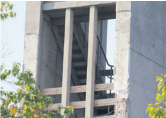
Der Beton bröckelt sehenden Auges
