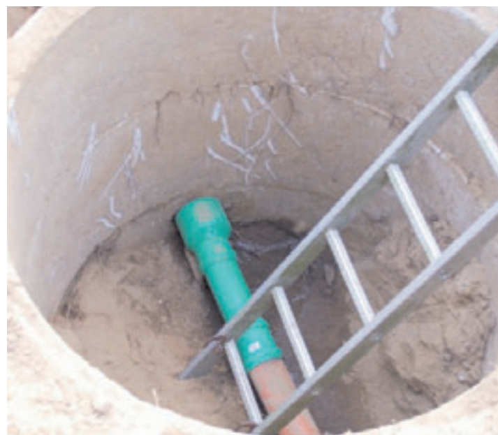
Bis zum 31.12.2020 müssen laut Behörde für Umwelt, Klima, Energie und Agrarwirtschaft (BUKEA) Dichtheitsnachweise für Grundleitungen und Schächte erbracht werden Foto: mk
