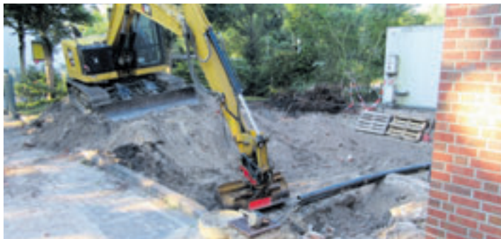
Bei Sondierungsarbeiten wurde auf dem Gelände des Wasserwerks eine Fliegerbombe aus dem 2. Weltkrieg gefunden Foto: W. Marsand
