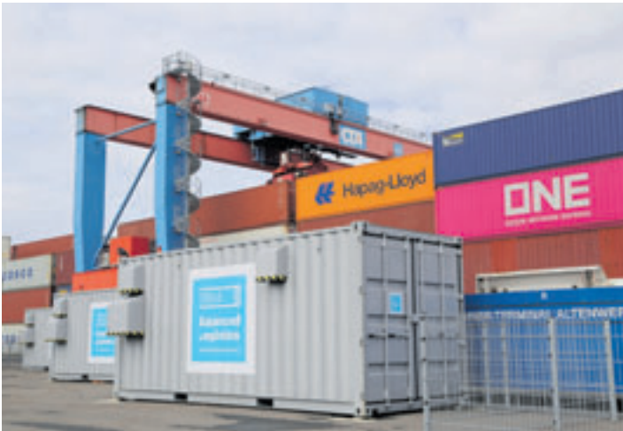
Ziel der HHLA ist es, den Kompensationsbedarf immer weiter zu reduzieren, was durch den Ausbau der batteriebetriebenen AGV-Flotte vorangetrieben wird Foto: HHLA
