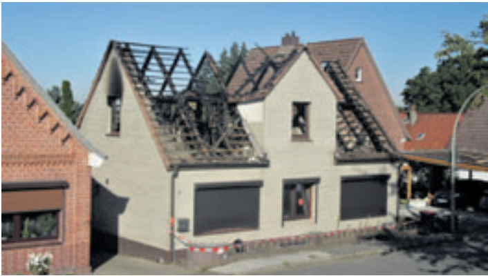
Durch den Brand ist das Gebäude schwer beschädigt worden Foto: W. Marsand
