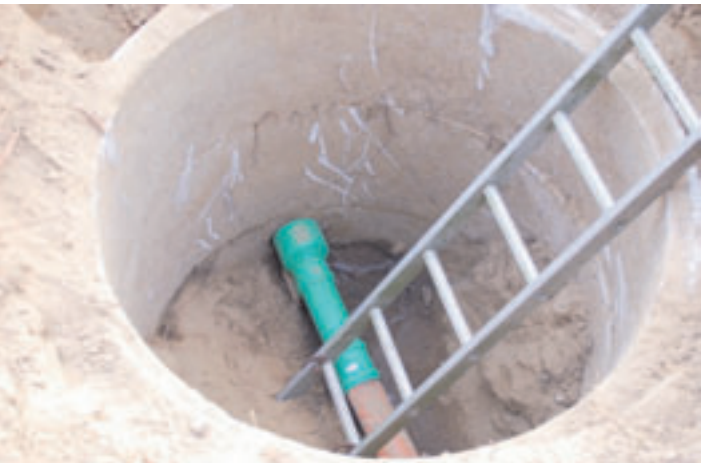
Bis zum 31.12.2020 müssen laut Behörde für Umwelt, Klima, Energie und Agrarwirtschaft (BUKEA) Dichtheitsnachweise für Grundleitungen und Schächte erbracht werden Foto: mk
