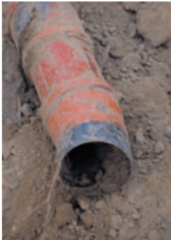
Defekte Abwasserleitungen tragen laut BUKEA zur Verschmutzung des Grundwassers bei. Foto: mk
