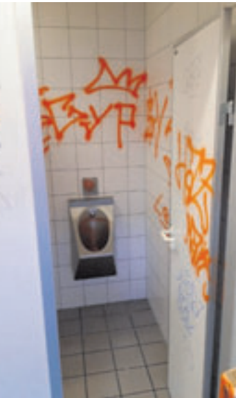
Der Zustand der Toiletten ist beklagenswert Foto: Gemeinde Neu Wulmstorf
