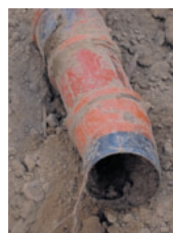
Defekte Abwasserleitungen tragen laut BUKEA zur Verschmutzung des Grundwassers bei Foto: mk
