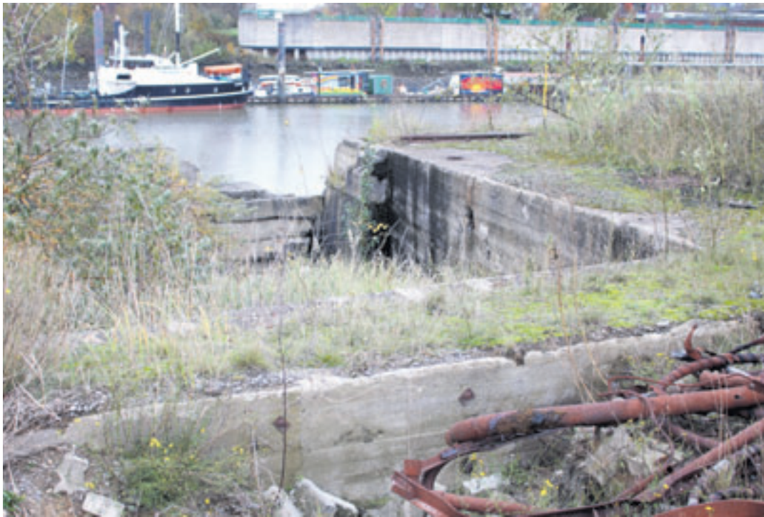
Die Kaimauer ist mittlerweile an mehreren Stellen abgängig
