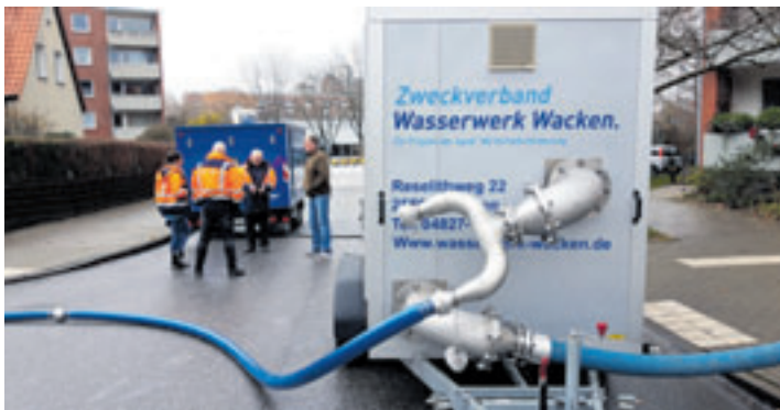
Um die Wasserversorgung während der Arbeiten ohne Einschränkungen sicherzustellen, installierte HAMBURG WASSER eine mobile Versorgungsanlage Fotos: W. Marsand
