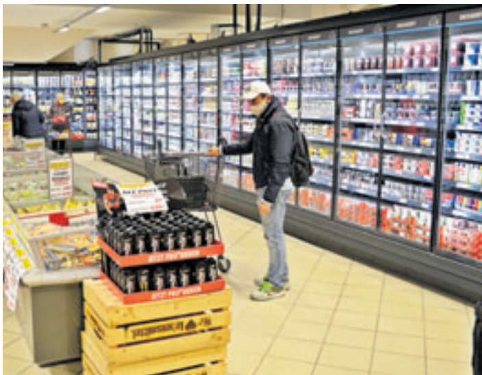
Mit der Umgestaltung wurden auch neue Kühlmöbel installiert und die Beleuchtung komplett auf LED umgestellt.
