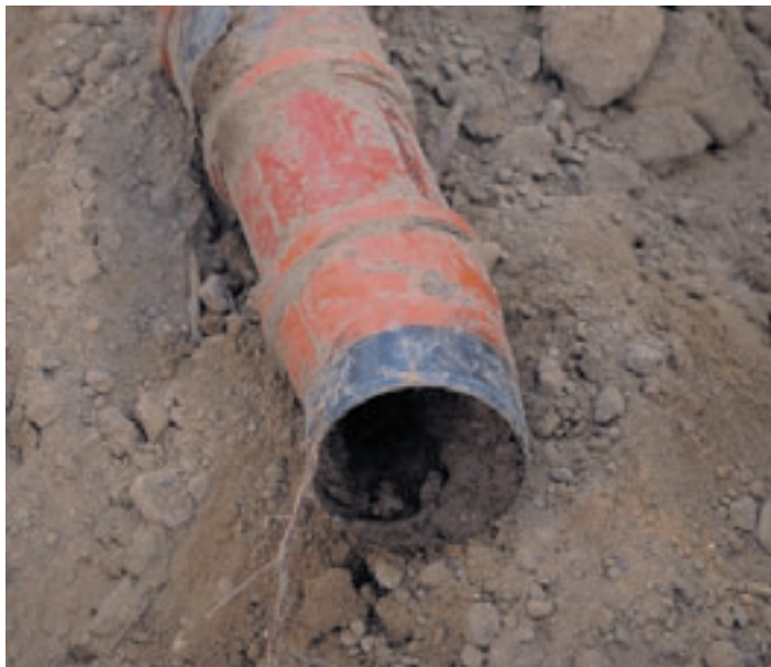
Defekte Abwasserleitungen tragen laut BUKEA zur Verschmutzung des Grundwassers bei Foto: mk
