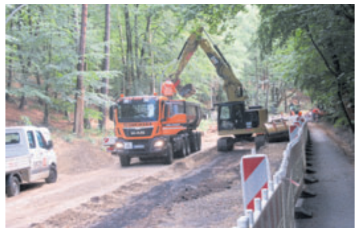
Im Laufe der Jahre jagte eine Panne die nächste auf der Baustelle des Ehestorfer Heuweges Foto: W. Marsand
