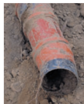
Defekte Abwasserleitungen tragen laut BUKEA zur Verschmutzung des Grundwassers bei Foto: mk
