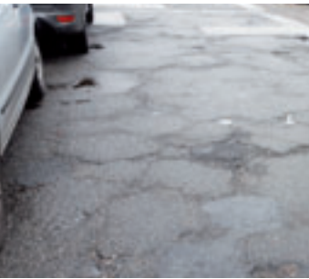
Schlaglöcher en masse auf dem Parkplatz Foto: W.M.
