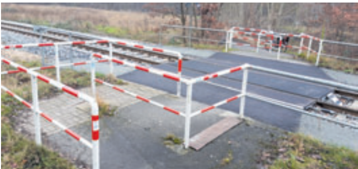
Für Lastenfahräder ist im Teilstück zwischen Hausbrucher Moor und der Hafenbahn-Querung Heykenaubrook am Bahnübergang kein Durchkommen. Mehrere Sicherungsbügel machen das Überqueren schier unmöglich. Foto: W. Marsand
